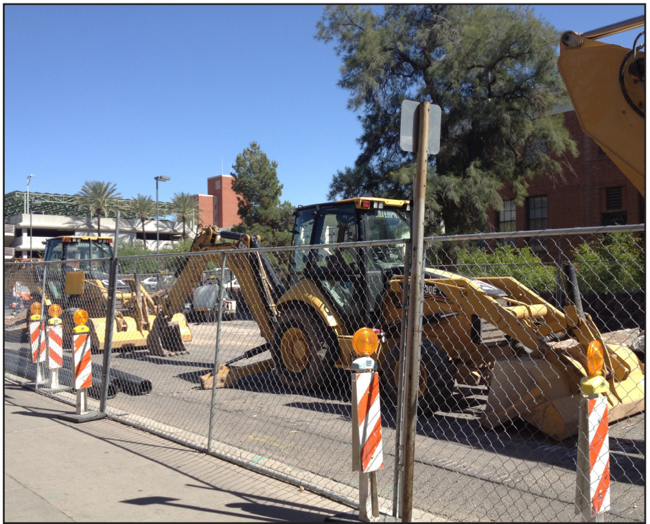
Construction crews are hard at work on Second Street at the University of Arizona campus on April 16, 2012 in Tucson, Ariz. | El equipo de construcción de la Second Street en el plantel de la Universidad de Arizona el 16 de abril, 2012 en Tucson, Arizona.
