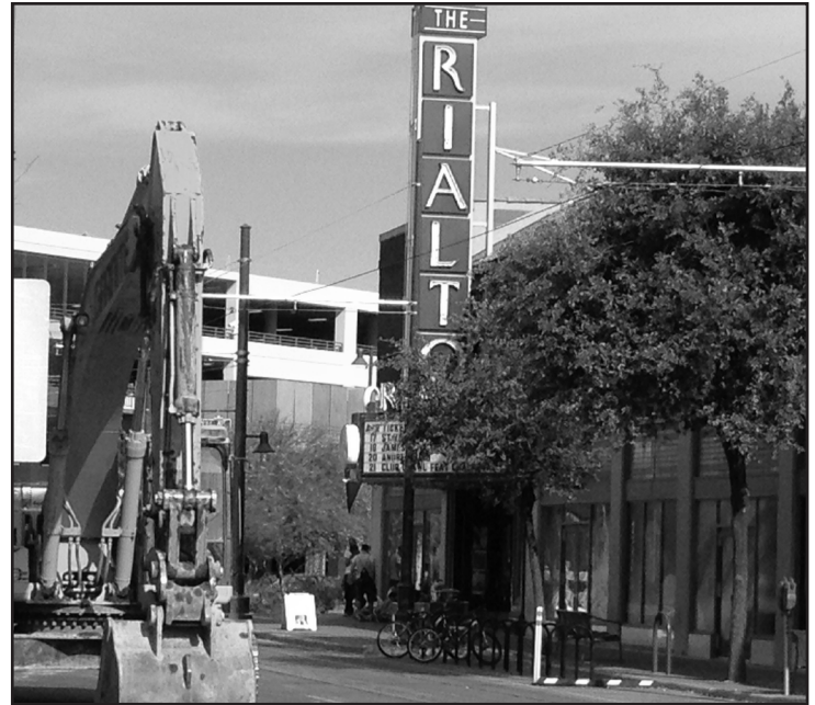
Construction for the Modern Streetcar is underway on Congress St., which is closed from Toole Ave. to Stone Ave. | La construcción para el moderno tranvía está en curso en la Congress St., la cual está cerrada desde la Toole Ave. hasta la Stone Ave.
